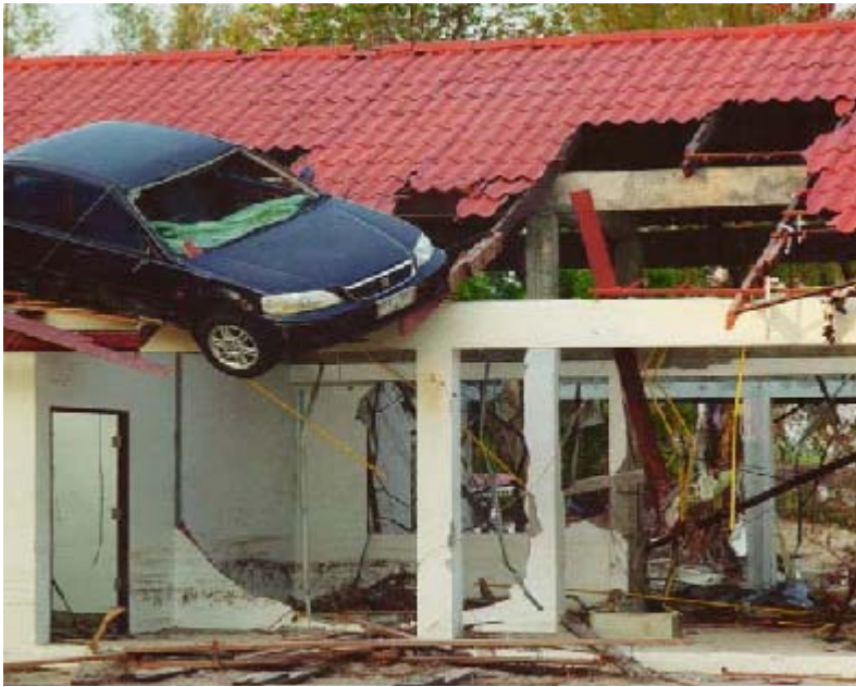
KhaoLak B地点；柱・屋根有，壁破壊
